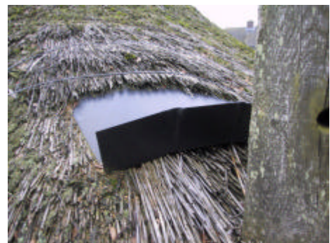
metalen lekplaat hergebruiken
