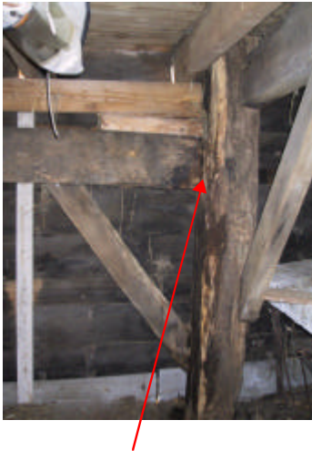
aantasting rotverwekkende schimmel in horizontale ligger
